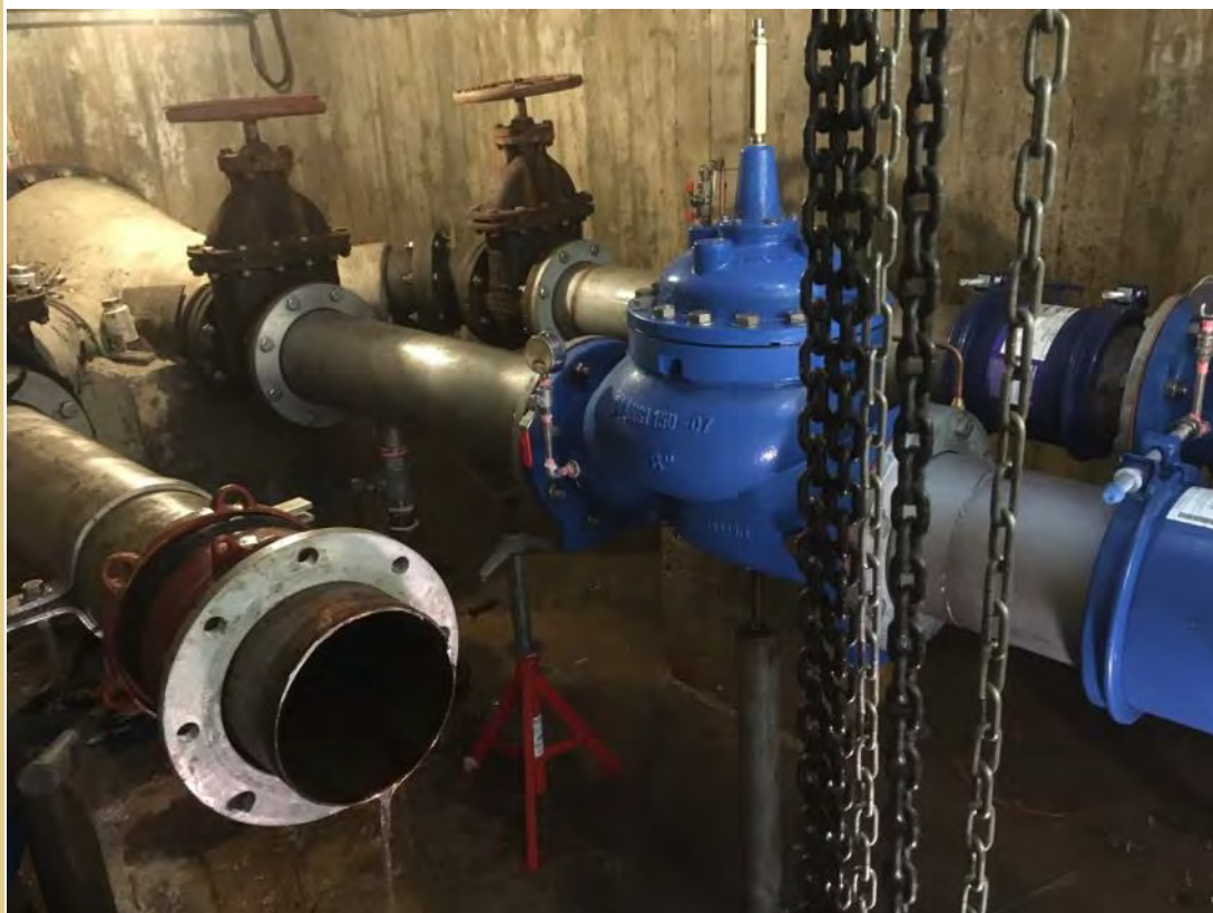
Nouvelle vanne régulatrice de pression—ancienne traverse
