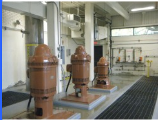
Station de pompage, eau brute
